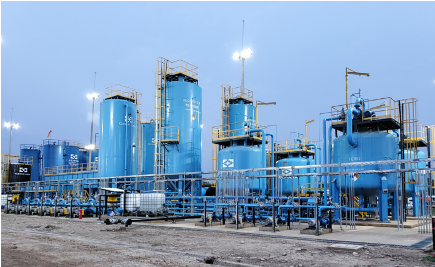
Figura 3. Planta de tratamiento 100.000 BWPD Estación Tigana, Geopark, Villanueva, Casanare.
